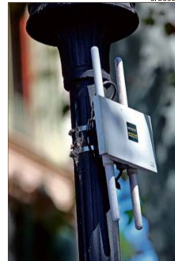
Detalle de un punto de conexión.
